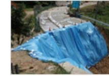
道路斜面の崩壊 (楠見教授)
